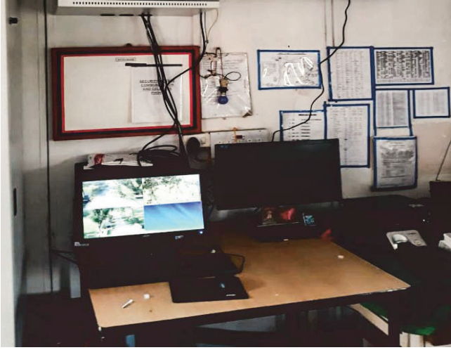
पूर्वी ओमांडा के तहत विभिन्न सैन्य स्टेशनों के लिए सीसीटीवी समाधान की खरीद और स्थापना
